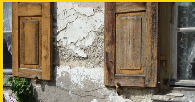
Schaden an der Aussenfassade
