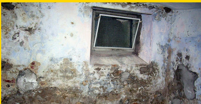
Schaden im Keller
