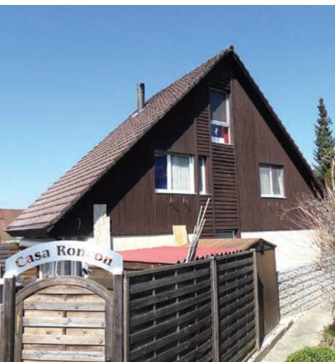
Das Haus der Familie Stebler vor der Sanierung.
