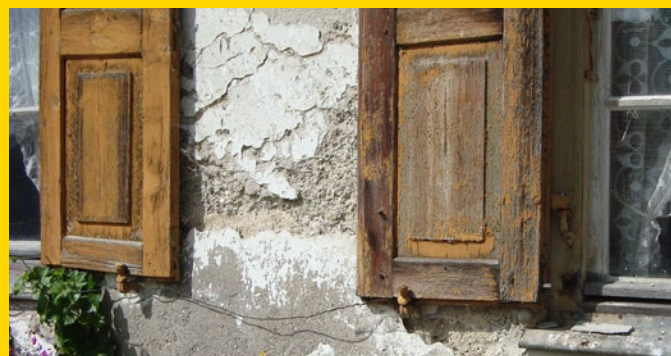
Dommmages sur la façade extérieure
